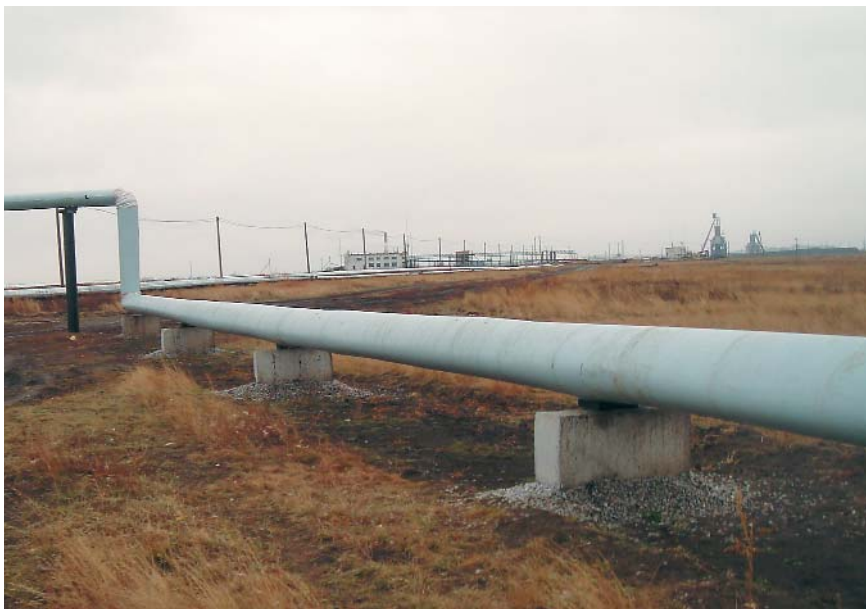
↻ Метан от системы дегазации пластов поступает на ГПЭС по трубопроводу
